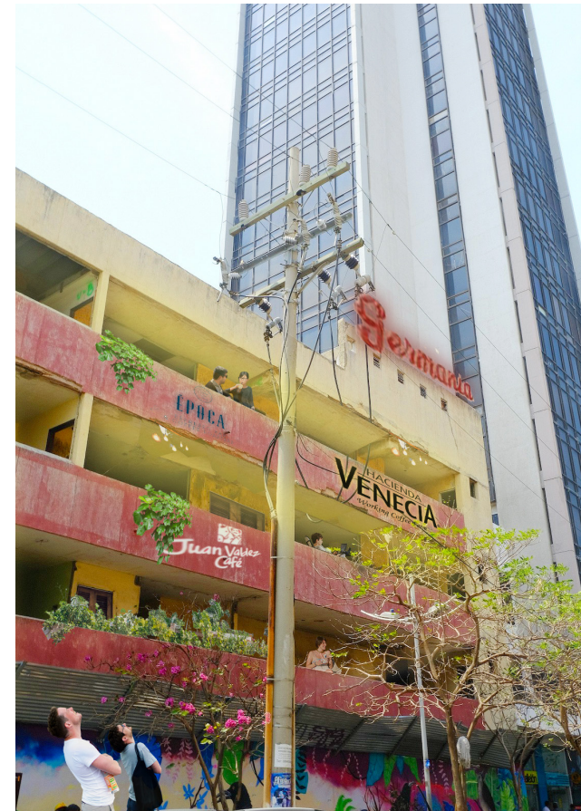
Figura 8.9 Rehabilitación de un edificio moderno para convertirlo en un centro de café.
